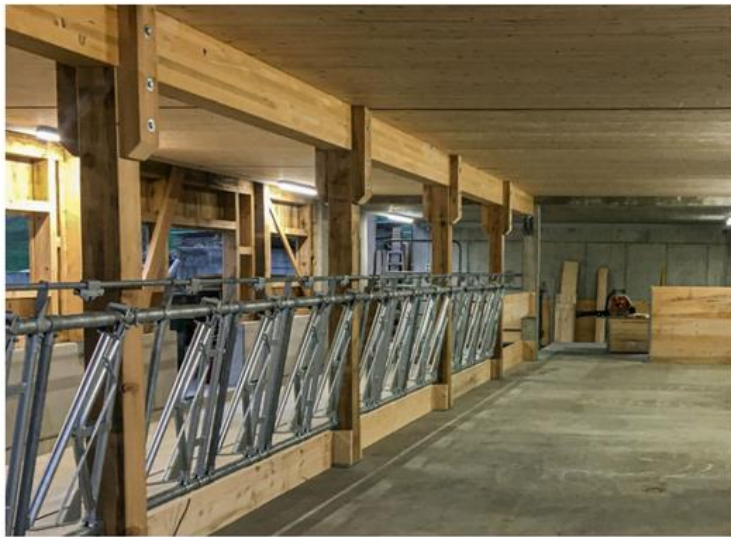
Für den Umbau zum Laufstall haben Jegerlehners rund 200 m 3 Holz aus dem eigenen Wald und 100 m 3 weiteres Bauholz (Leinträger, verarbeitetes Holz) aus der Region verbaut. Bild: Truber Gallowayhof
